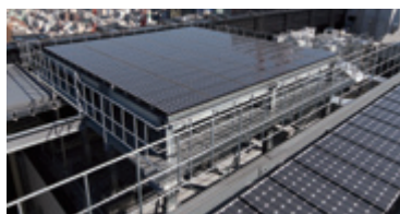
駿河台新館ビル屋上に設置した太陽光パネル
